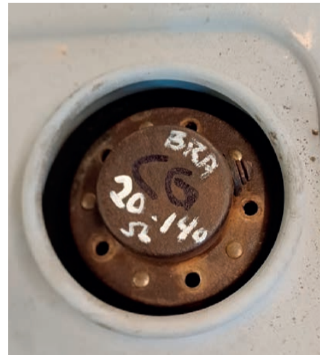
I tilfelle noko skjer er denne velfungerande 90 år gamle sendareren avmerka med verdier for full og tom tank.
